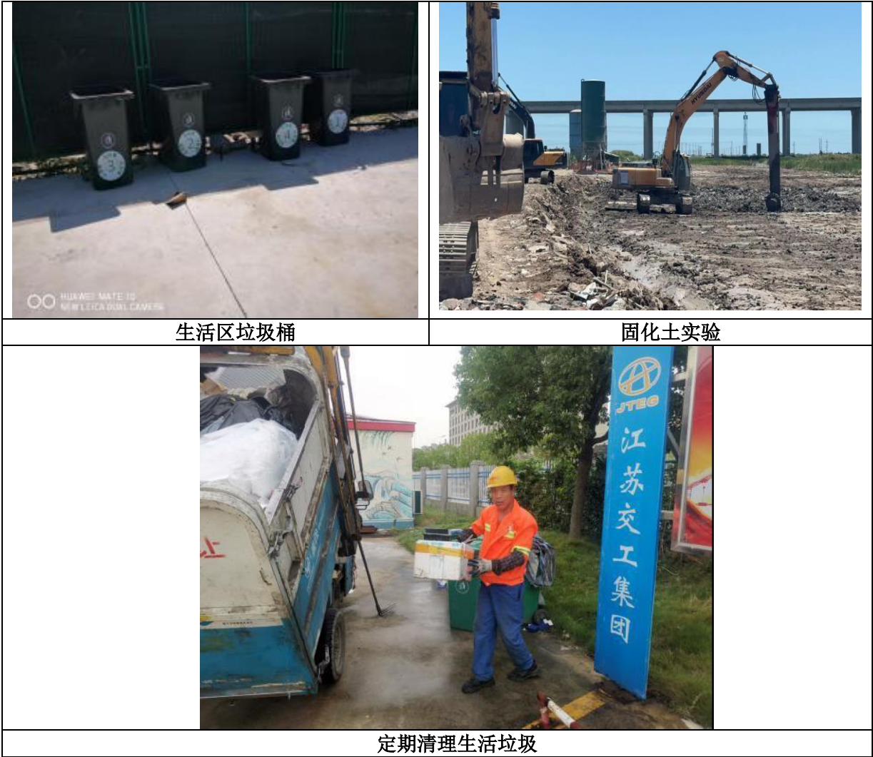
图 5.1-8 固废污染防治措施照片
